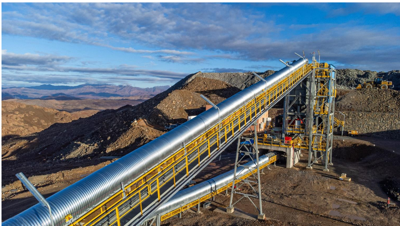
Figure 1 – Mise en service en cours
