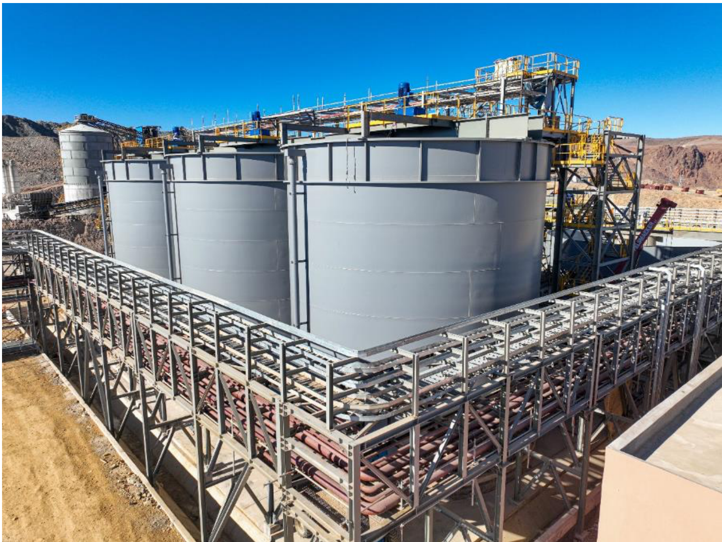
Figure 2 – Achèvement des cuves de cyanuration
